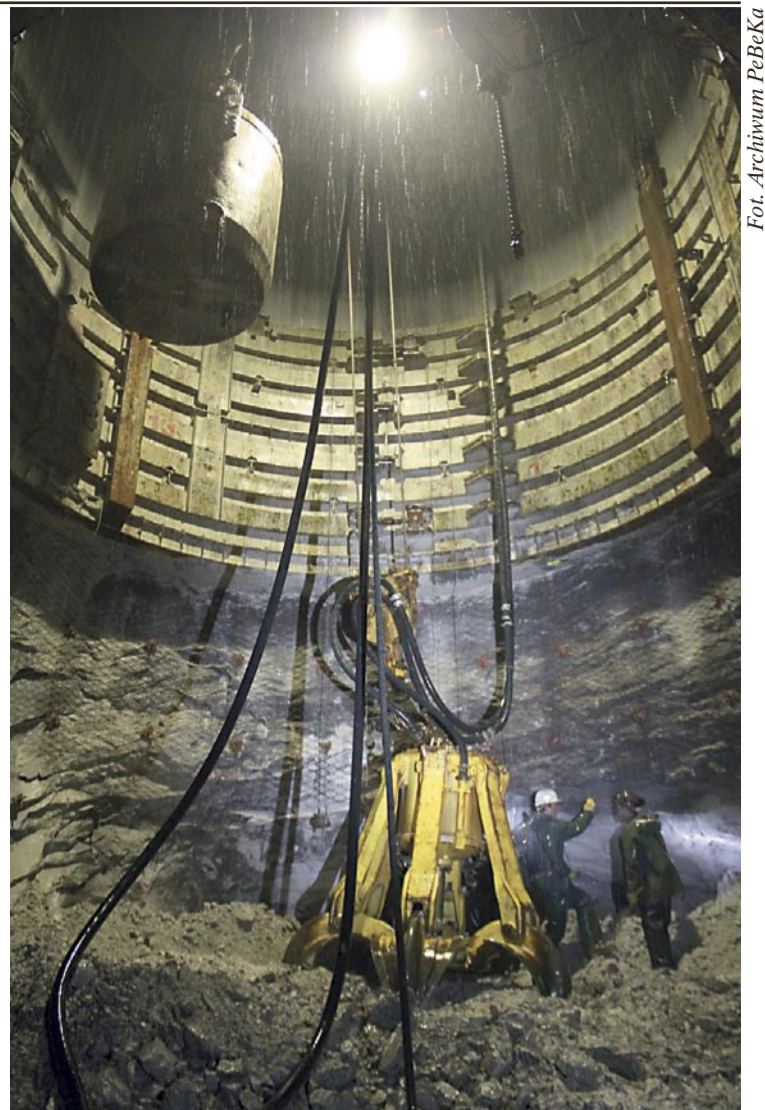
Głębinienie szybu w obudowie betonowej na poziomie 1015 m. Ostatnim etapem, po zbitciu szybu na głębokości 1209 m, będzie wykonanie wlotów lunet wentylacyjnych oraz rzępa wraz z korkiem szybu. Prace te potrwać do jesieni.
