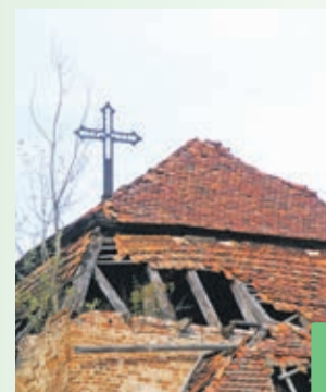
Dach wymaga szybkiej interwencji.
